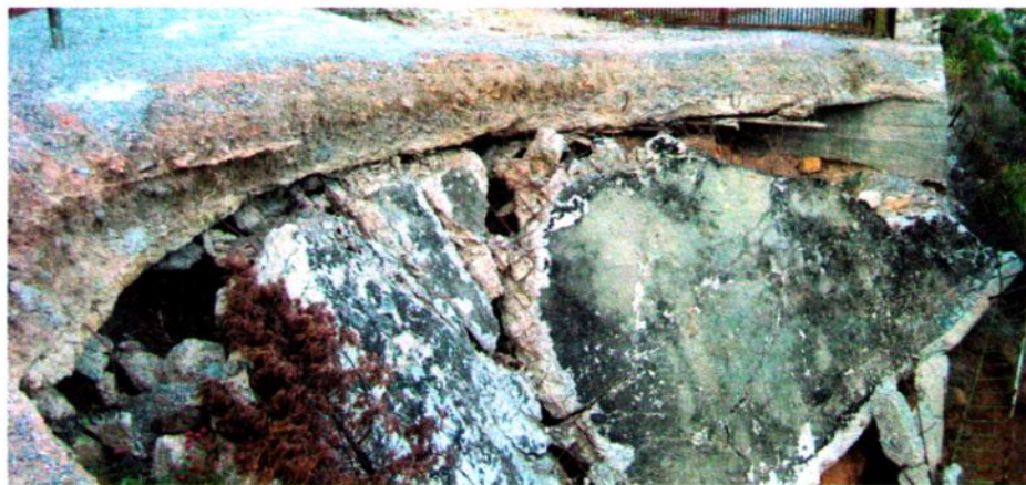
Рис. 167. Оползень на горном склоне разрушил дорогу
