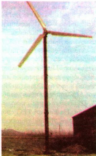
Мал. 58. Вітрова електростанція.
