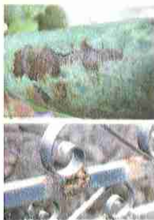
Рис. 68. Коррозия металлических изделий
